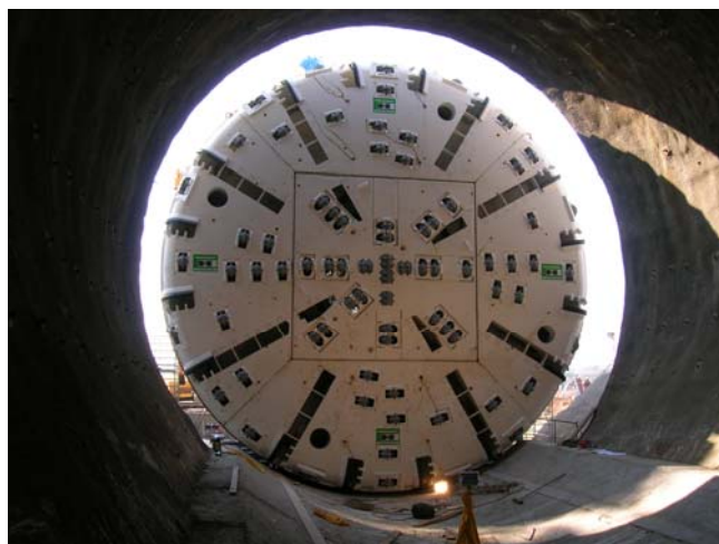
Bohrkopf der Vollschnittfräse (d ca. 13m) in der Startöhre West des Stierschweiffeldtunnels
